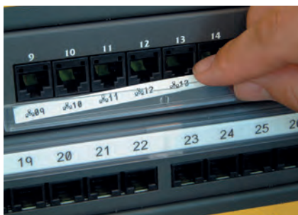
Labels voor aansluitklemmen en patchpanelen
