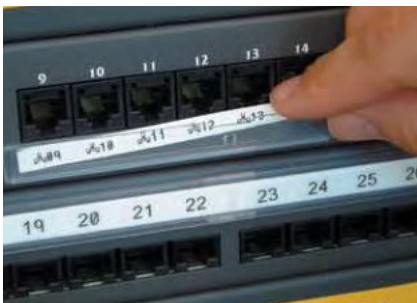
Labels voor patchpanelen
